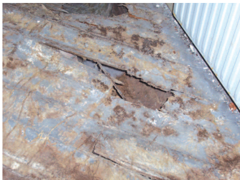
Plancher d\u00e9grad\u00e9 par des m\u00e9rules, sous un rev\u00eatement de sol plastique.
